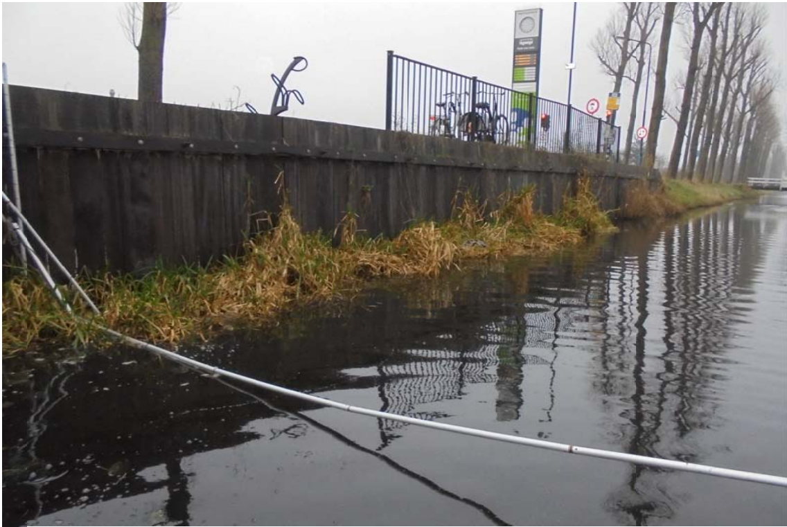
Houten beschoeiing bij bushalte nabij inrit Park van Luna (oostelijke zijde, nabij DWP1-4)
