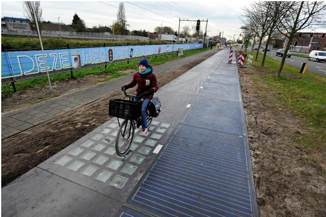
Voorbeeld: fietspad met zonnecollectoren in Krommenie
