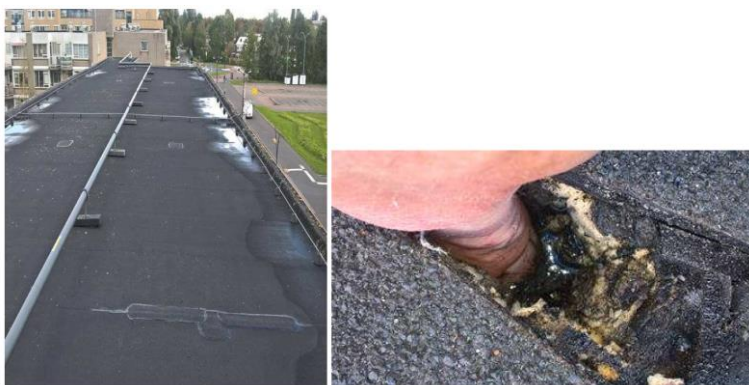
Figuur 13: Huidige dakconstructie met vochtige plekken in isolatie (bron: gemeente Heerhugowaard)
