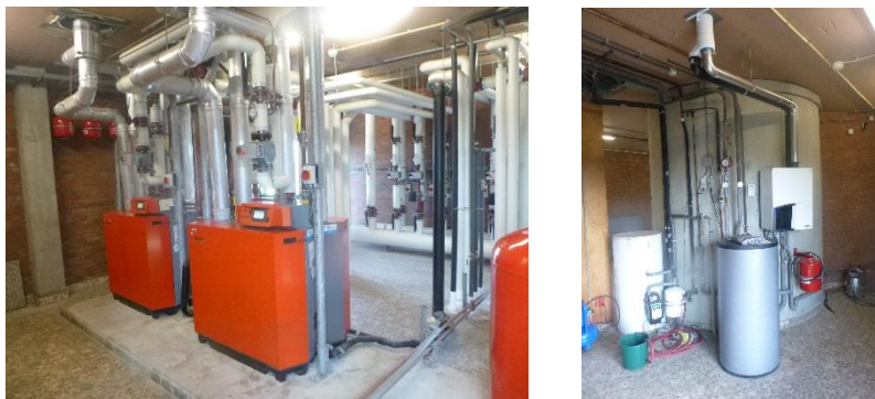
Figuur 15: Huidige verwarmingsinstallatie (links) en tapwatersysteem (rechts)
