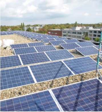
Figuur 16: PV-panelen op gebouwdeel E
