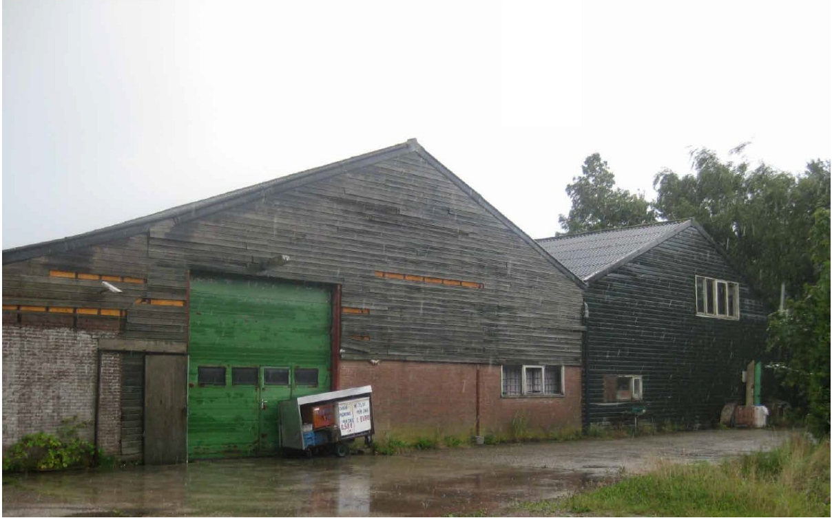
Figuur 4. De bedrijfsgebouwen verkeren in slechte staat
