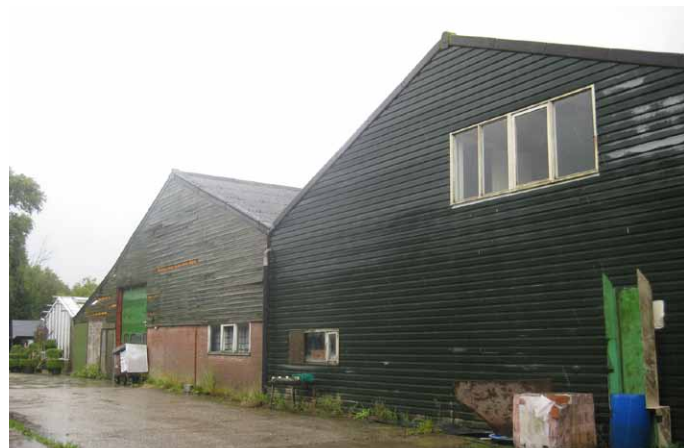
DE BESTAANDE BEDRIJFSGEBOUWEN ZIJN IN EEN SLECHTE STAAT.
