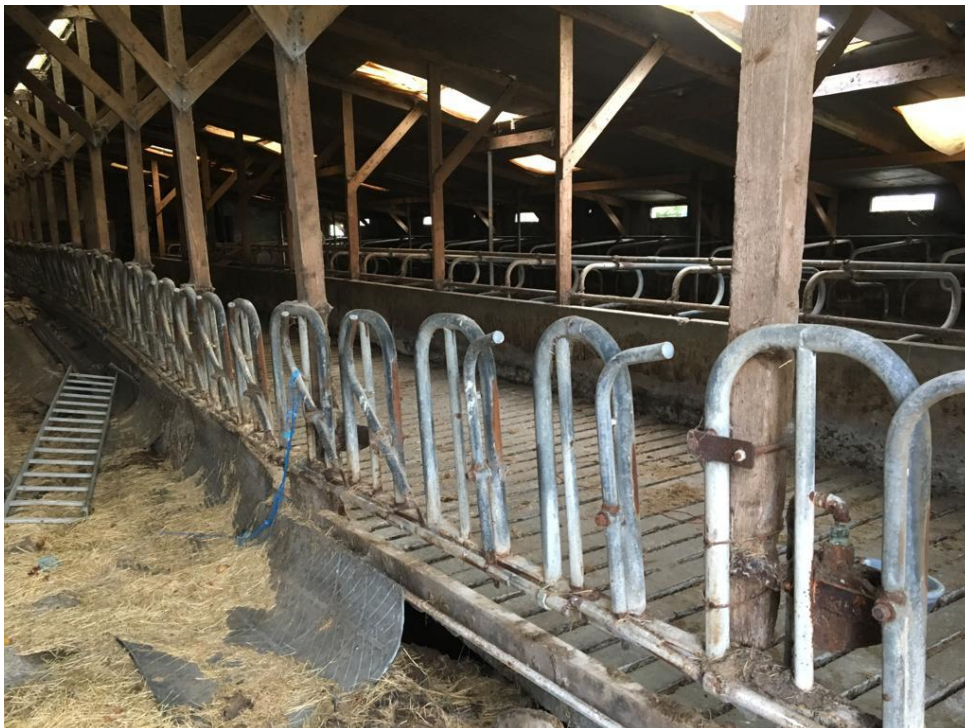
Afbeelding 3: Rundveestal, verzakking stal in de kelder
