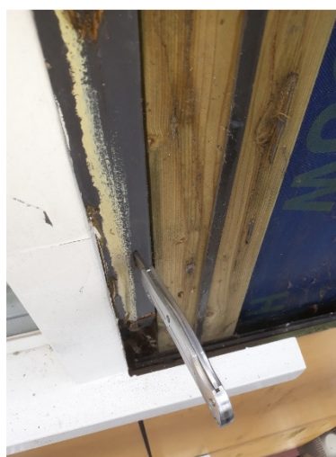
Houtrot in lat langs kozijn.
