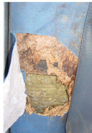
Houtrot in OSB plaat en achterhout.
