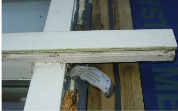
Houtrot achter kozijn oor.
