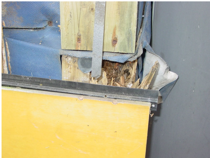
Houtrot achter gevelplaat.
