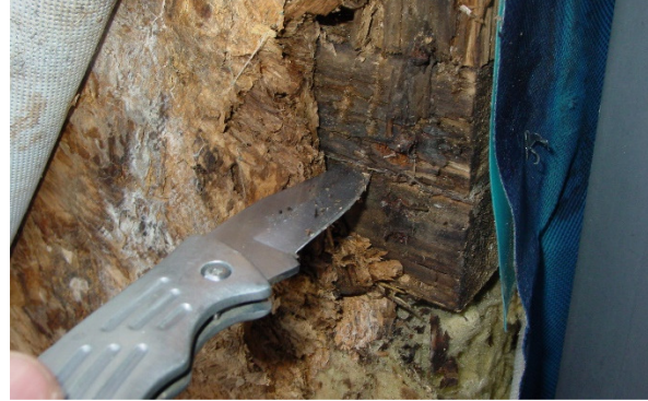
Houtrot in stijl en regelwerk.
