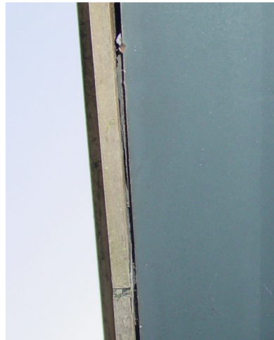
Ventilatie ruimte tussen paneel en aftimmering te smal
