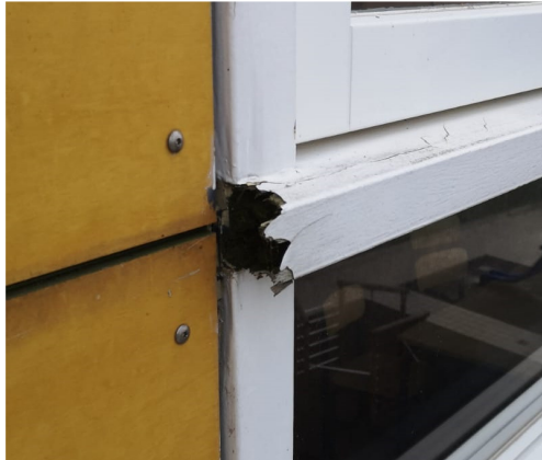
Kozijn oor is weg gerot.
