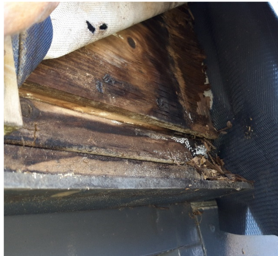
Onderzijde deel van een stijl van regelwerk verrot.
