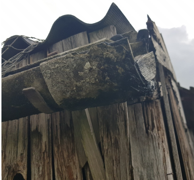
Foto 5. Asbesthoudende dakgaten en asbesthoudend Golflaten dak in slechte staat
