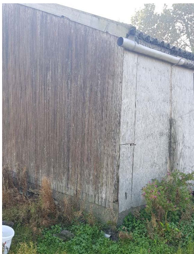
Foto 18. Noordwestzijde schuur met asbesthoudend dak en dakgoot in slechte staat
