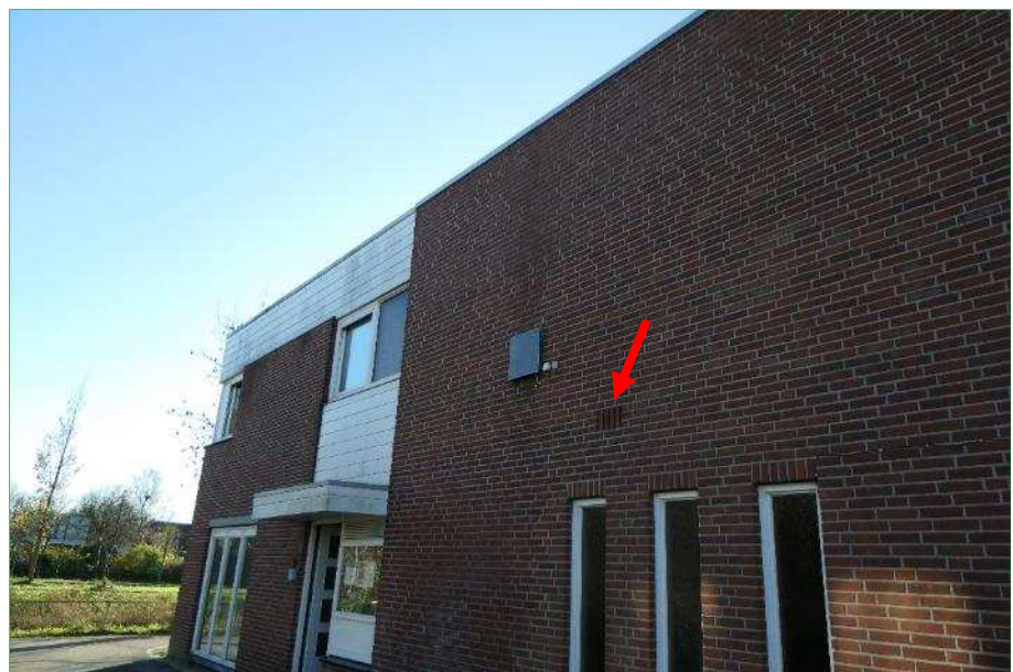
Gaten (ventilatierooster) in de muur bij Hectorlaan 17-19 die mogelijk toegang geven tot voor vleermuis .geschikte achterliggende ruimtes.
