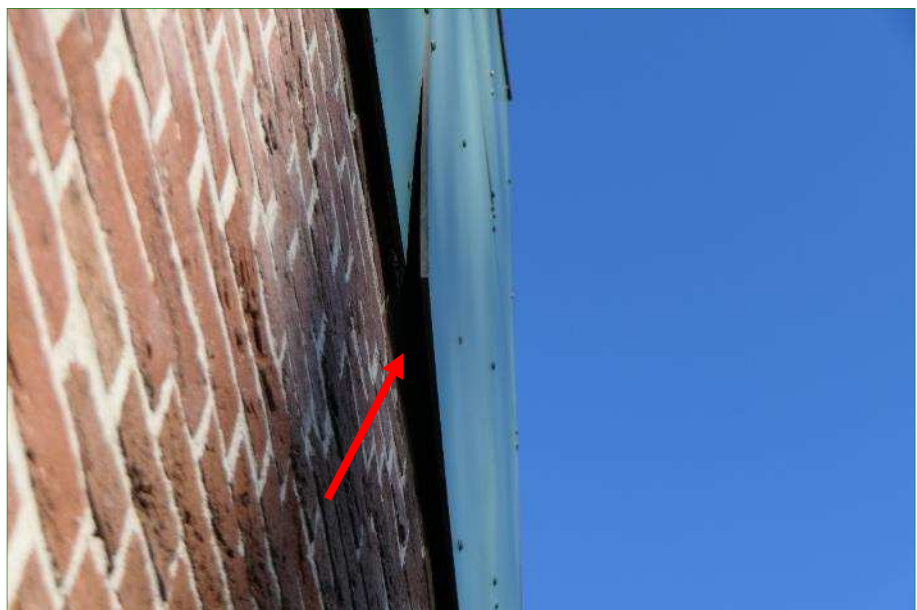
Kier bij beplating van Deimoslaan 5 die mogelijk toegang geeft voor vleermuizen geschikte achterliggende ruimtes.
